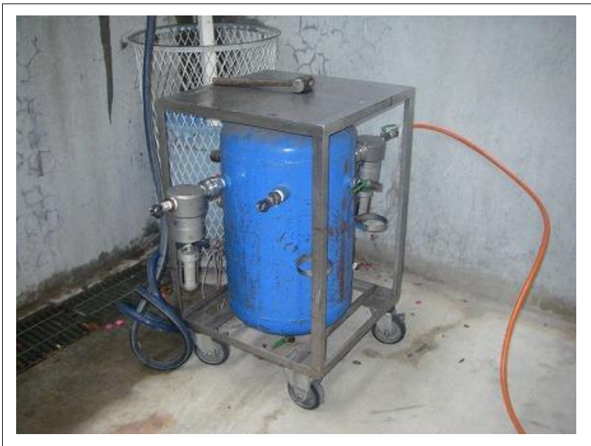
ドライエアー機 (水抜きタンク)
